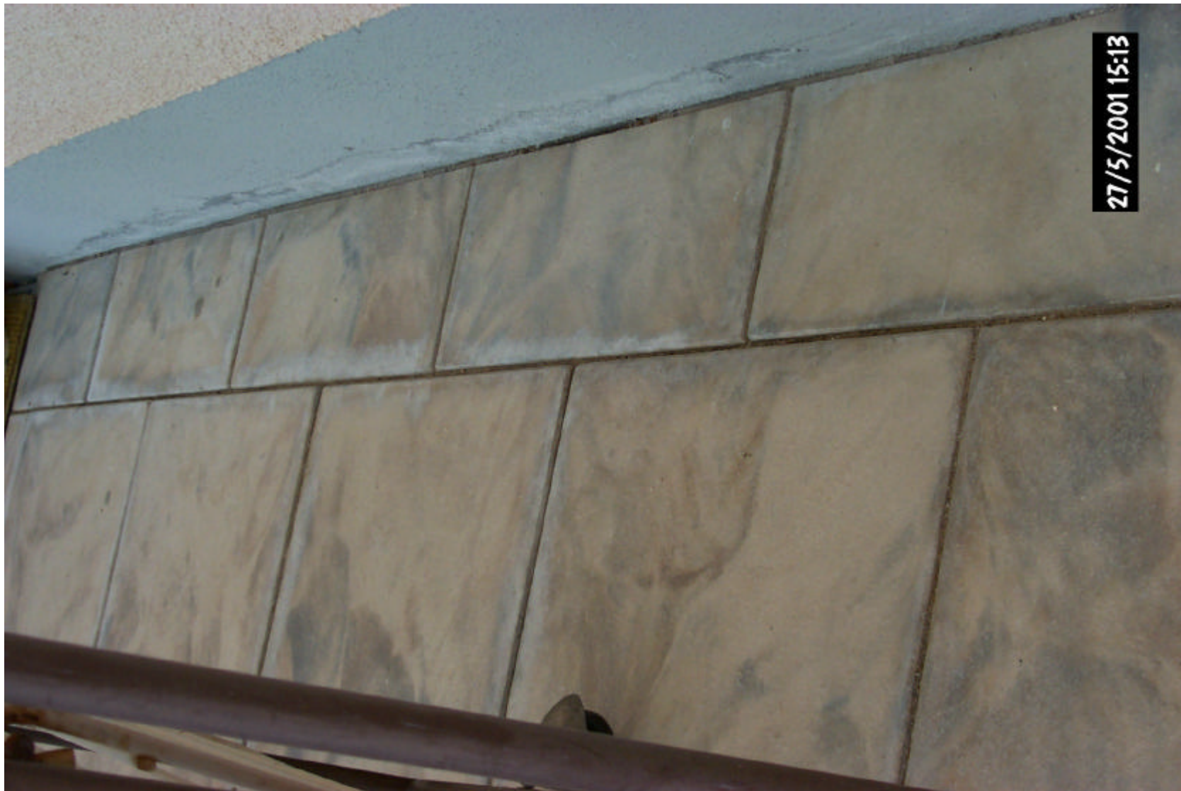
Aufsteigende Feuchtigkeit durch zu tief liegende Abdichtung
