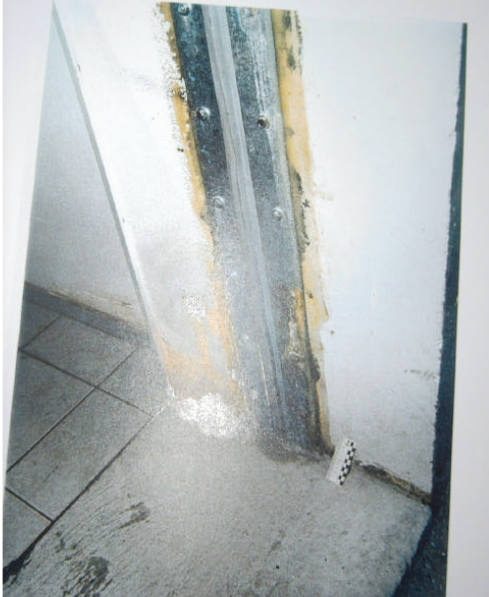
Foto 22 Unten tritt etwas Feuchtigkeit aus
